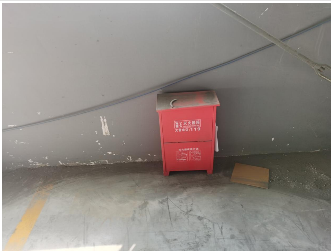
厂区内灭火器
