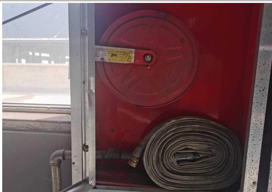
厂区内消防系统
