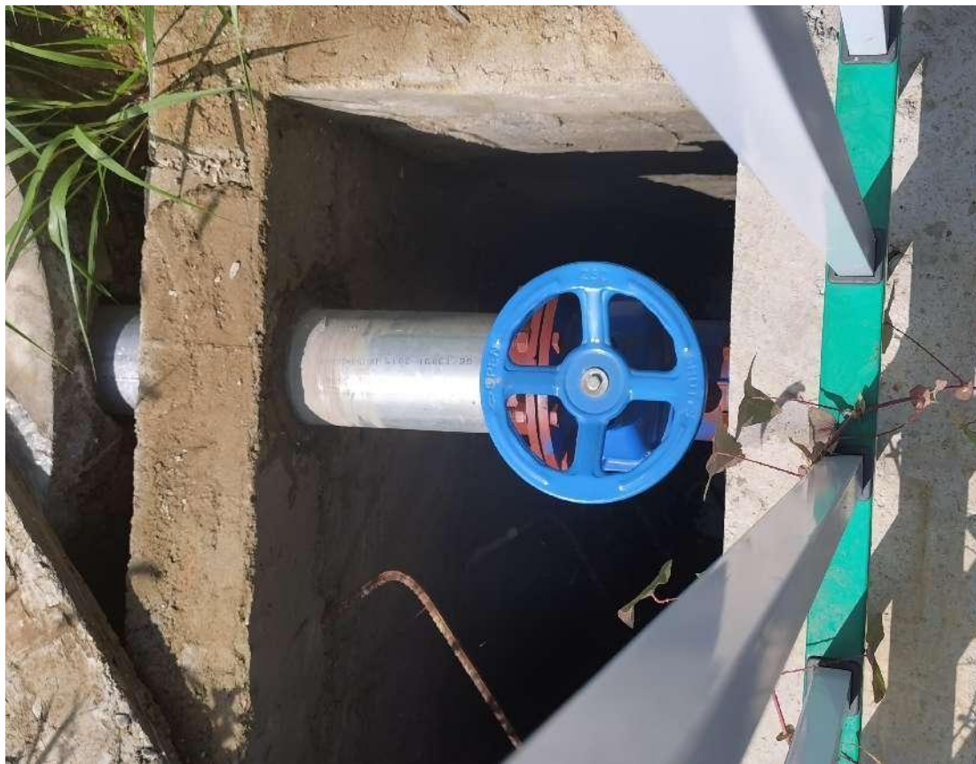
厂区雨水切换阀
